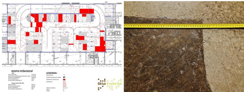
Obr. 6: Prieskumy stavu podláh hromadných garáží – delaminácia (aj opakovaná v už sanovaných miestach)
