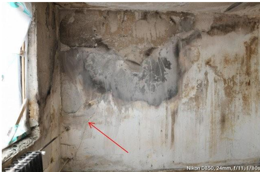
Obr. 5: Šikmá trhlina v stene na 11. poschodí zo strany bytu č.48
