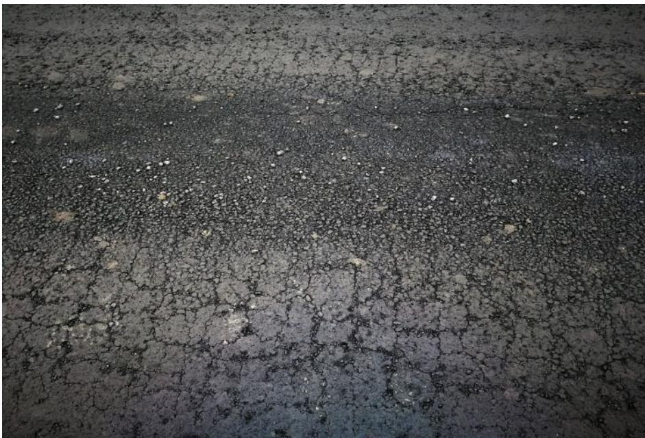
Obr. 1: Ilustračný obrázok - Sieťový rozpad asfaltovej vozovky
