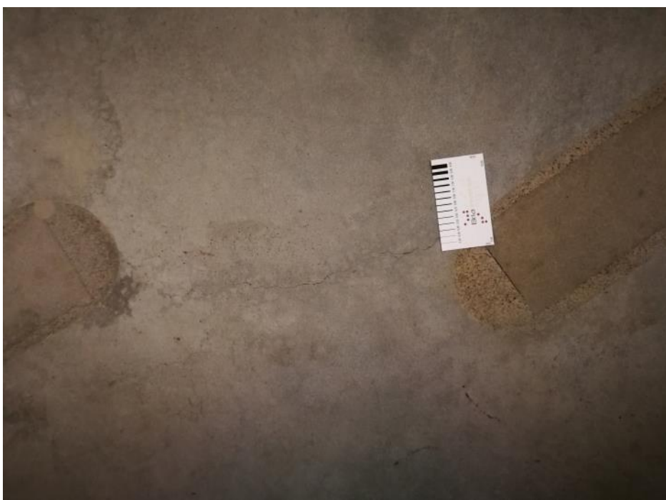
Obr. 9: Trhlina v podlahe garáží
