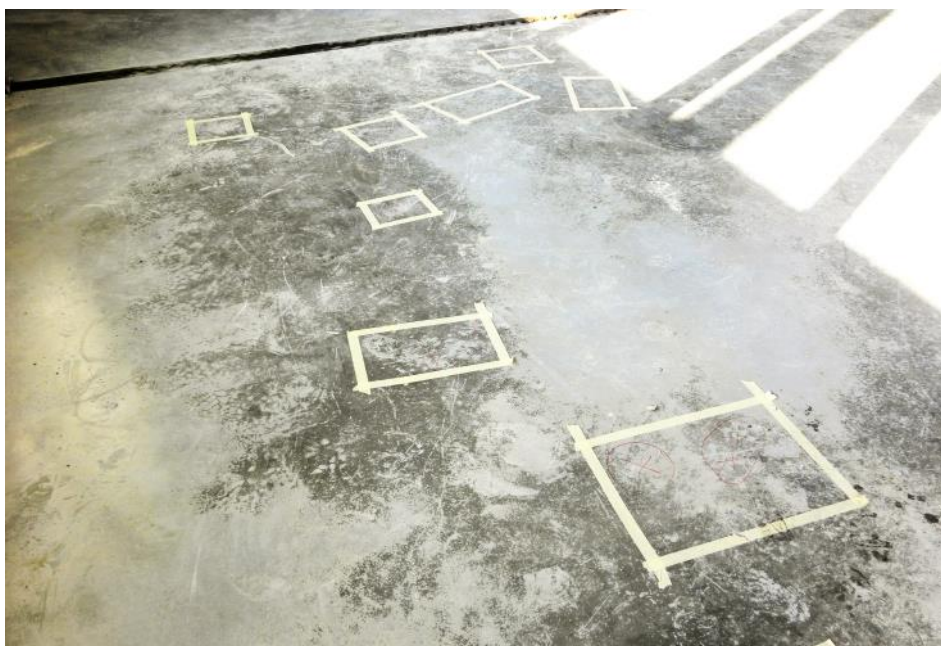
Obr. 2: Ilustračný obrázok – Delaminácia pancierovej podlahy
