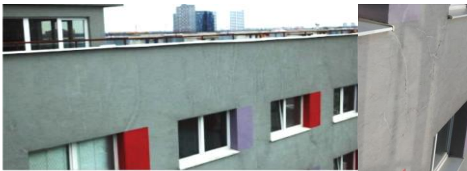
Obr. 2: a) Trhliny na povrchu zateplenia v miestach pod strešnou atikou. b) Stav po 3 rokoch od sanácie pretmelením – 11. poschodie [autori]
