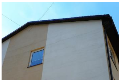
Obr.5: Vonkajšia omietka bytového domu
