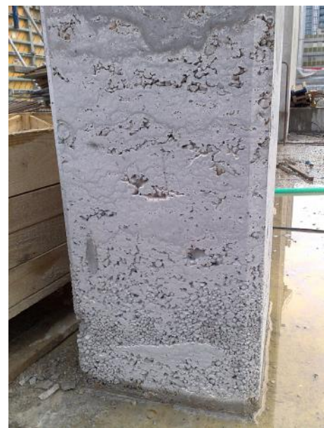
Obr. 12: Strata jemných zložiek betónu v päte stĺpa
