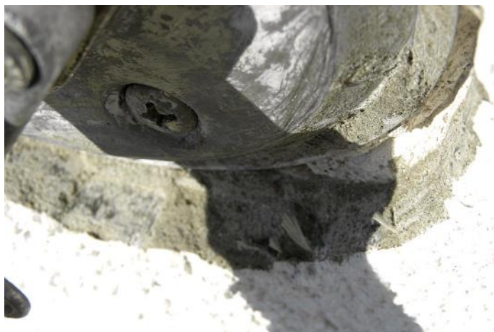
Obr. 10: Nesprávne umiestnenie výstužnej mriežky až k povrchu omietky
